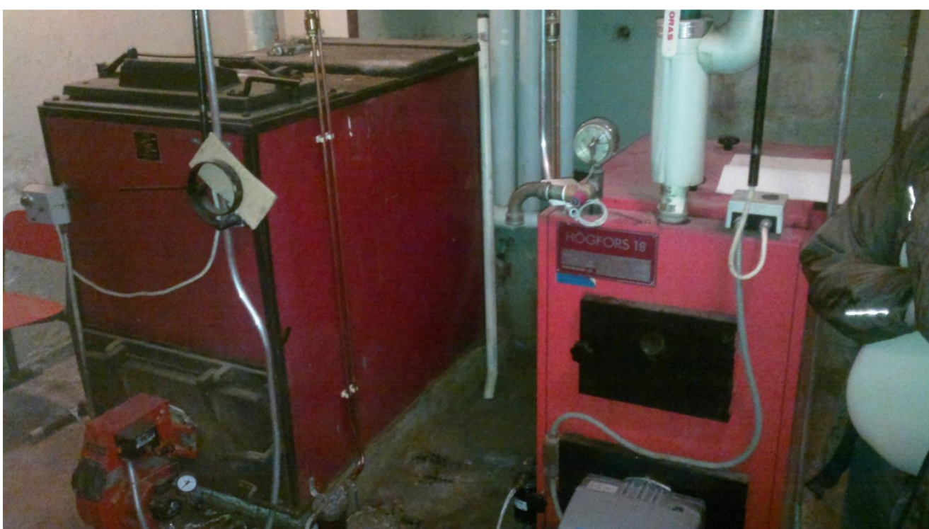
Kuva 2. Vähäkankaan koulun pannuhuone. Vasemmalla Lakan ja oikealla Högforsin kattila
